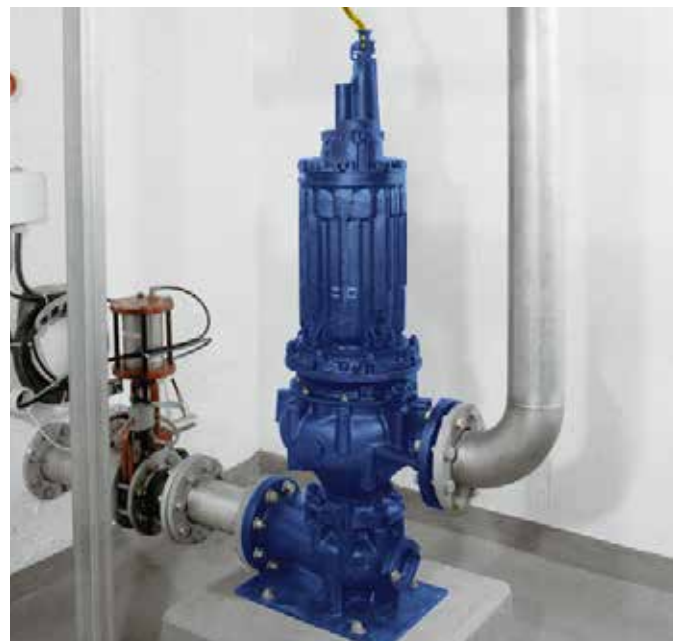
Trocken aufgestellte Abwasserpumpe, Motor mit Konvektionskühlung
