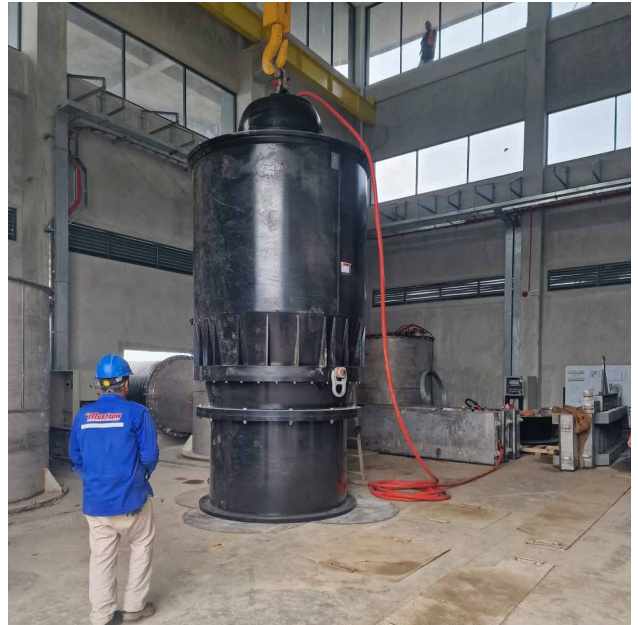
De Bedford SAF-pomp van 10.000 l/s bij de installatie ter plekke
